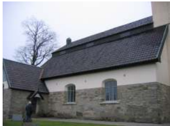
Bild 16: Norra nedre takfallet där man kan se att pannorna skevar något.
