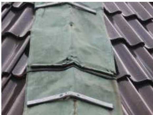
Bild 3: Befintlig plåt på fallande nock över koret.
