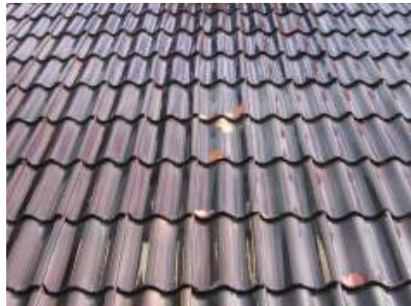
Bild 2: Glasyren har lossnat på några tegelpannor.
