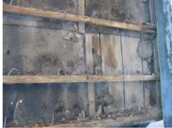
Bild 12: Befintlig trasig lumppapp, norra fallen.
