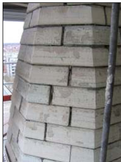
Stora delar av fogbruket är borta
