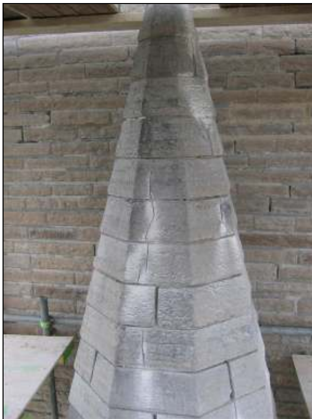
Sprickor i stenen är uppsågade
