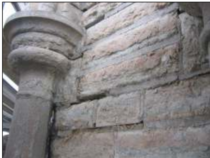
Fogens bindemedel har lakats ur av vatten
