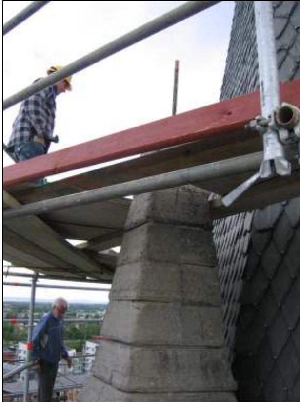
Fialprydnad är nedplockad och järnstaget är synligt
