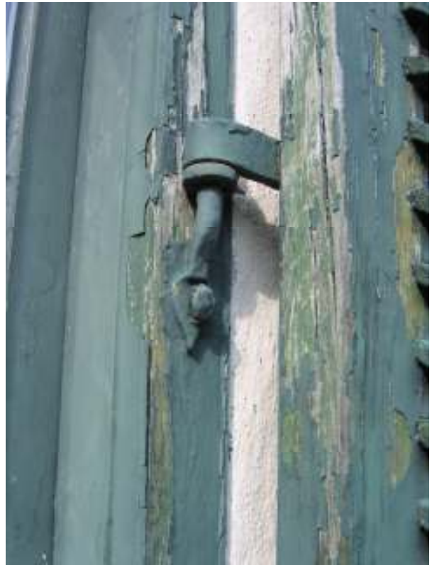
Beslag till jalousier före åtgärder.
