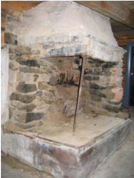
Eldstaden i västra rummet har ej åtgärdats.
