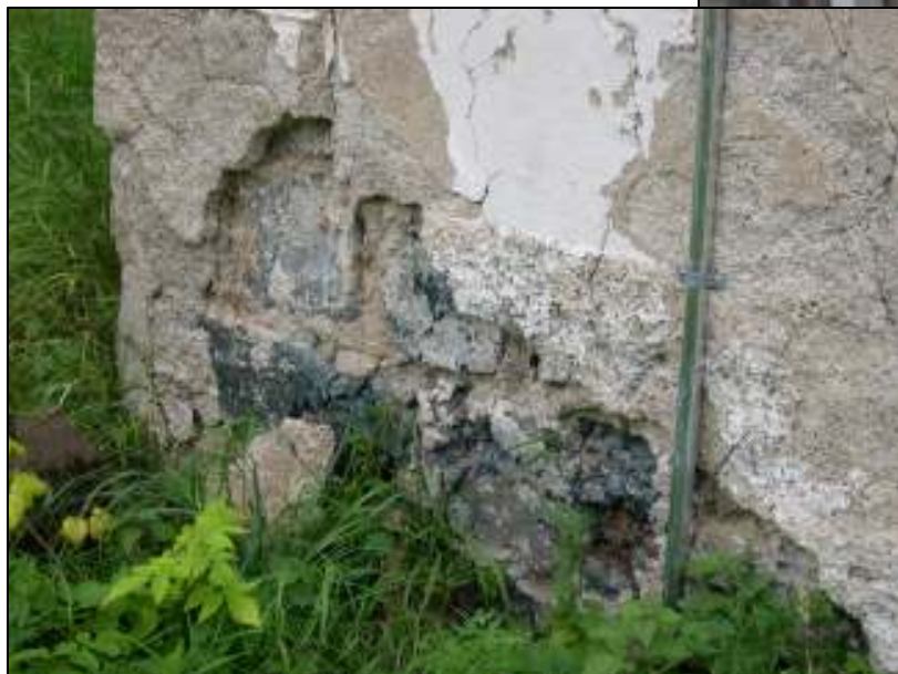
Skador på sockeln, före åtgärder år 2005.
