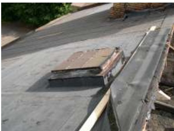
Papptak och taklucka före åtgärd, norra takfallet
