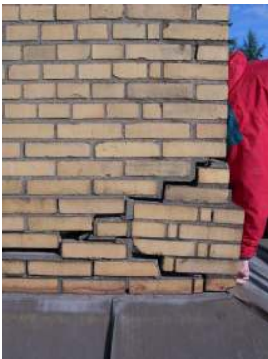
Sättningskador i mittsektionens yttermur
