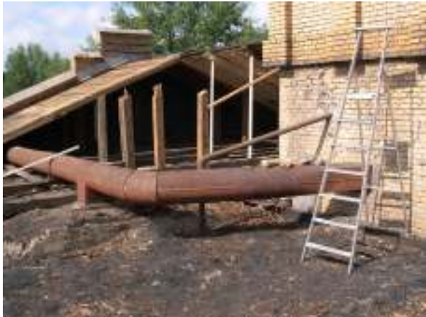
Nedre delen av den yttre skorstensmuren syns till vänster i bilden. Från utrymmet innanför muren har det gått en ventilationsledning genom röret som syns på bilden. Själva hålet i murverket var igensatt
