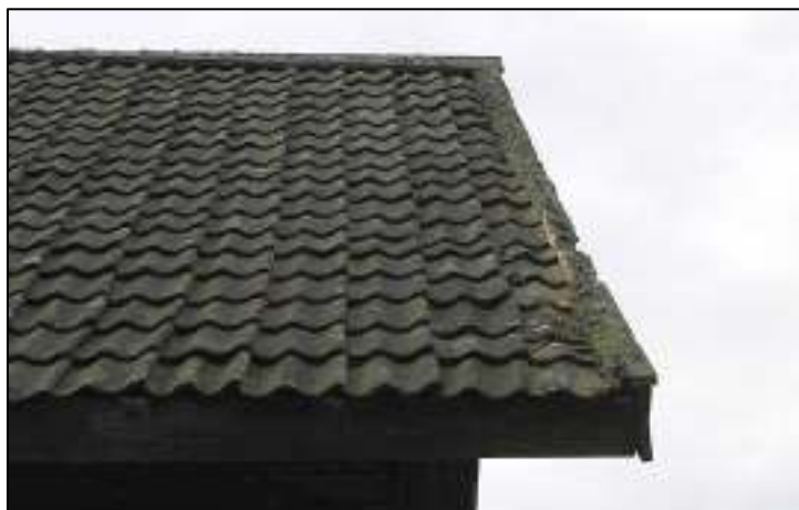
Taknock, vattbräda och taktegel före åtgärder.
