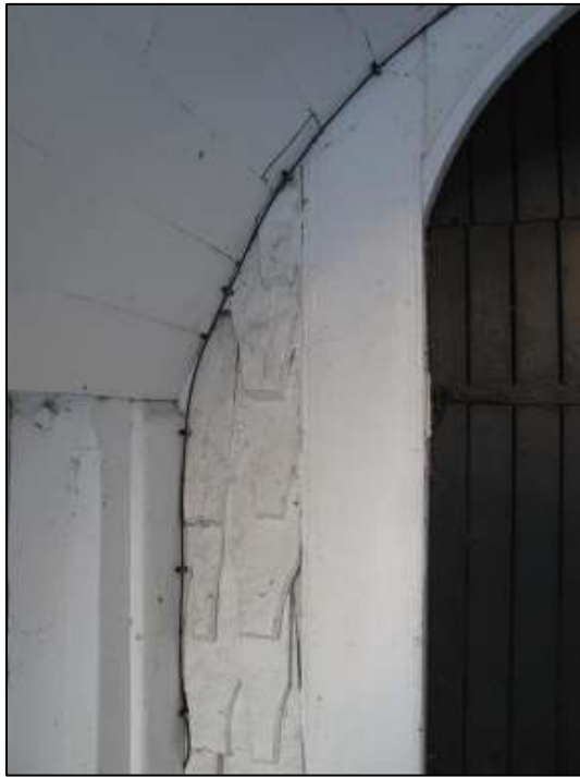
Värmedetekterande kabel i anslutning till port
