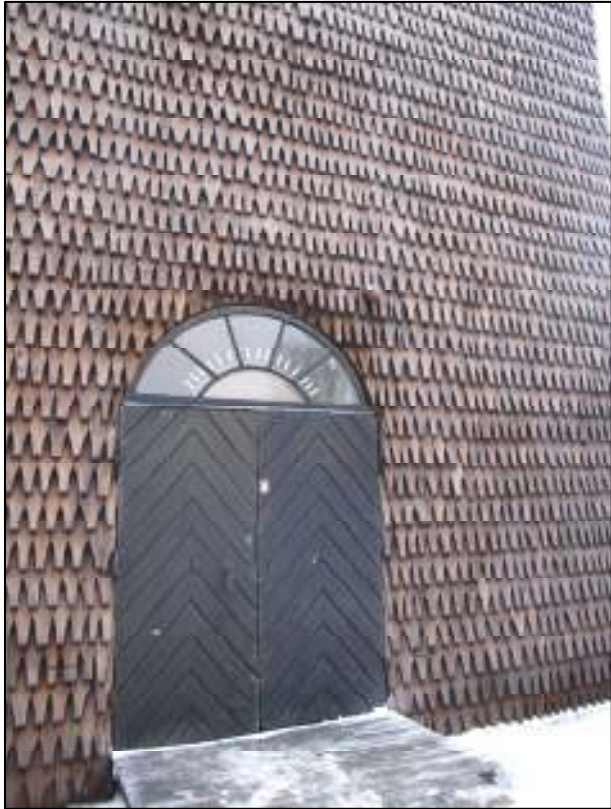
Siren monterad på fasaden vid västra ingången
