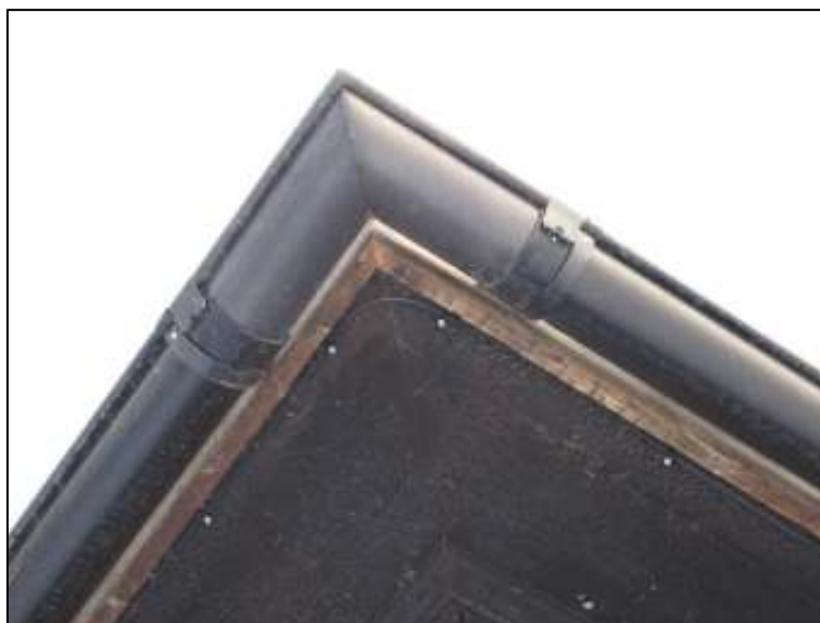
Värmedetekterande kabel längs med takfot
