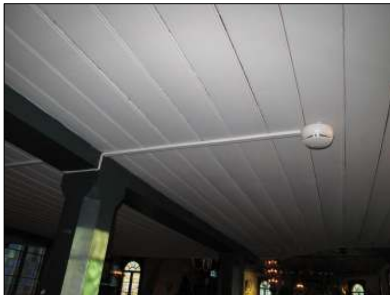
Rökdetektor samt kabelkanal
