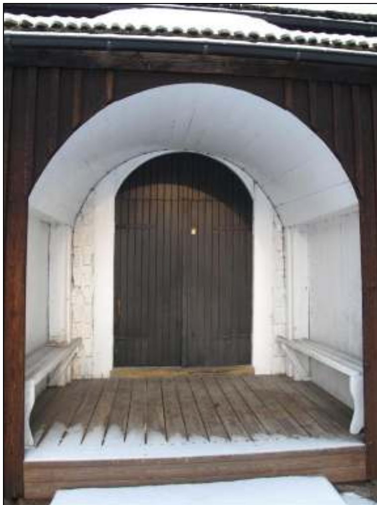
Värmedetekterande kabel dragen runt port
