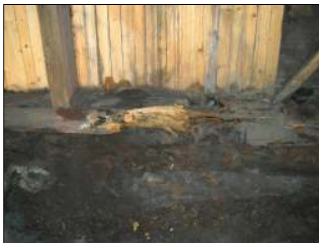
Syll som skall bytas
