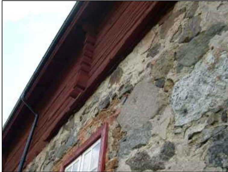
Rötskadad fotbräda på norra fasaden
