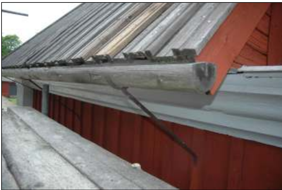
Takfot vid träränna, före åtgärd
