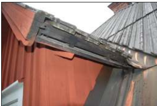
Takfot och rännedal på takkupa före åtgärd
