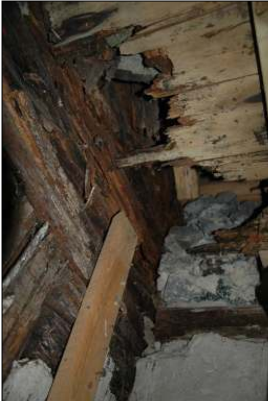
Mellanvägg och innertak med rötskador
