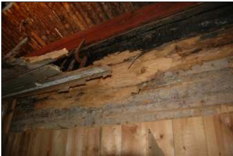
Väggens övre del uppvisar skador
