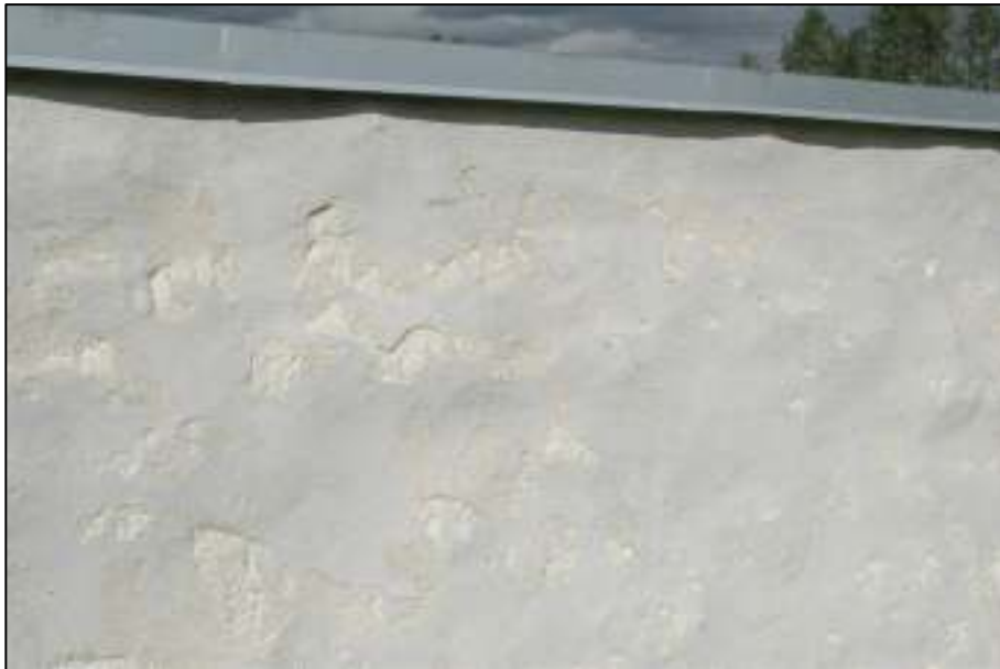
Frostskadad puts på östra murens södra sida
