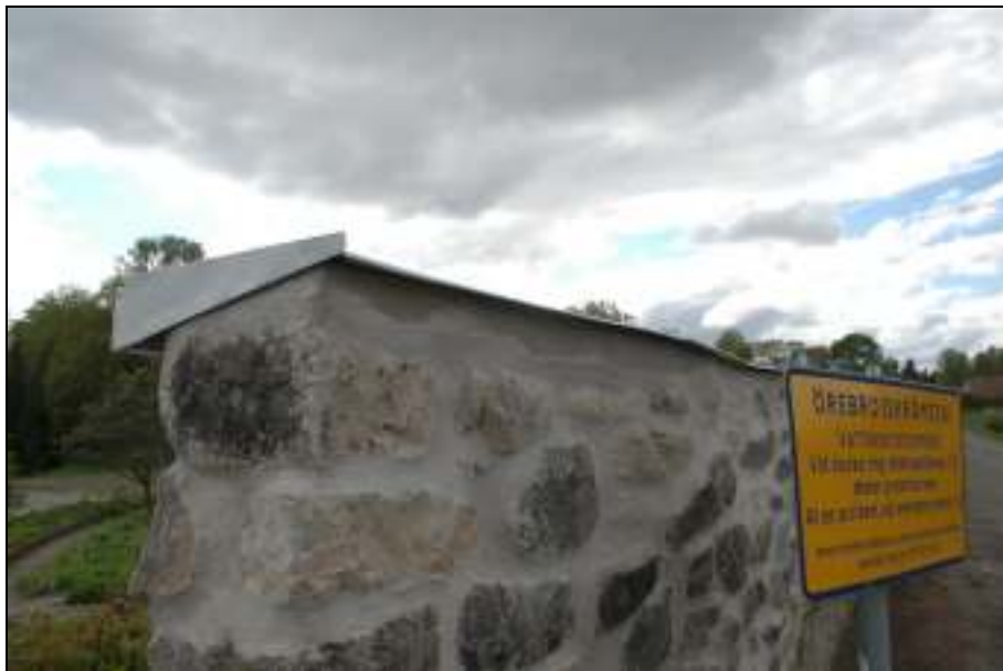
Putshyllans cement är synlig under plåtavtäckningen
