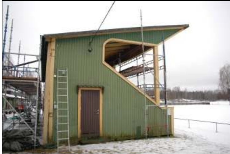
Panel i behov av åtgärd
