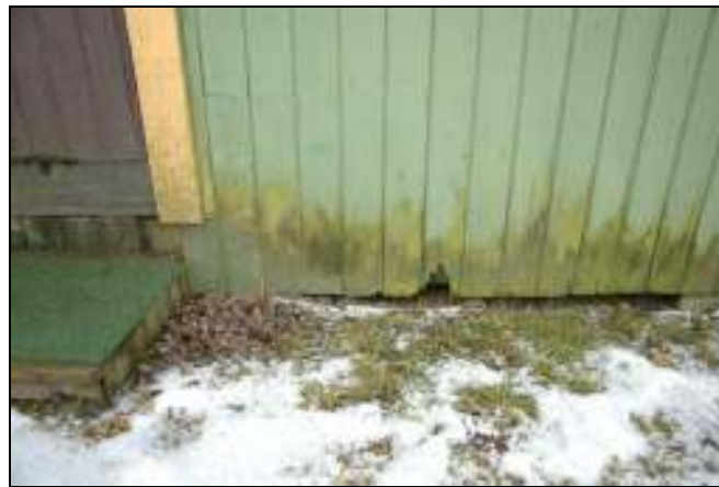
Nedre delen av panelen är rötskadad
