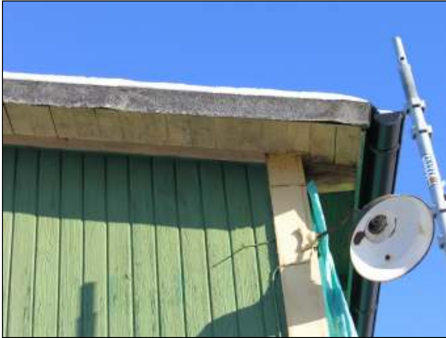
Befintlig papp nedvikt över samt spikad i takfotsbräda
