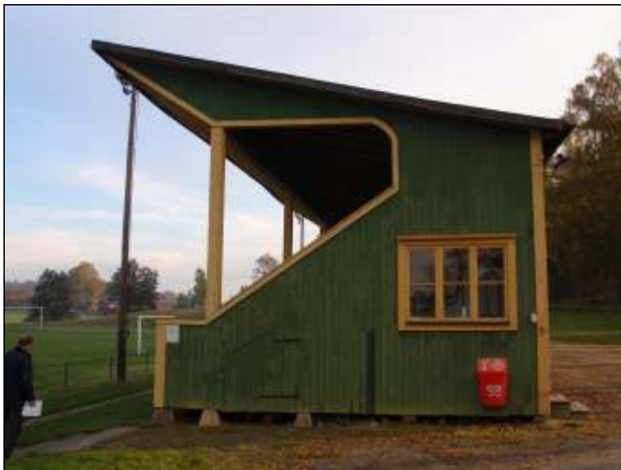
Panelen är delvis rötskadad
