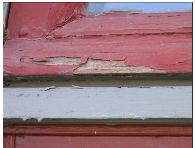
Detalj av fönsterkarm före åtgärd.
