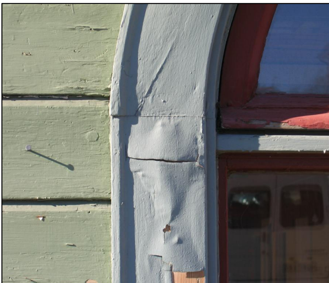
Fönsterfoder före åtgärd.
