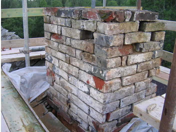
Skorstenarnas murverk före renoivering.
