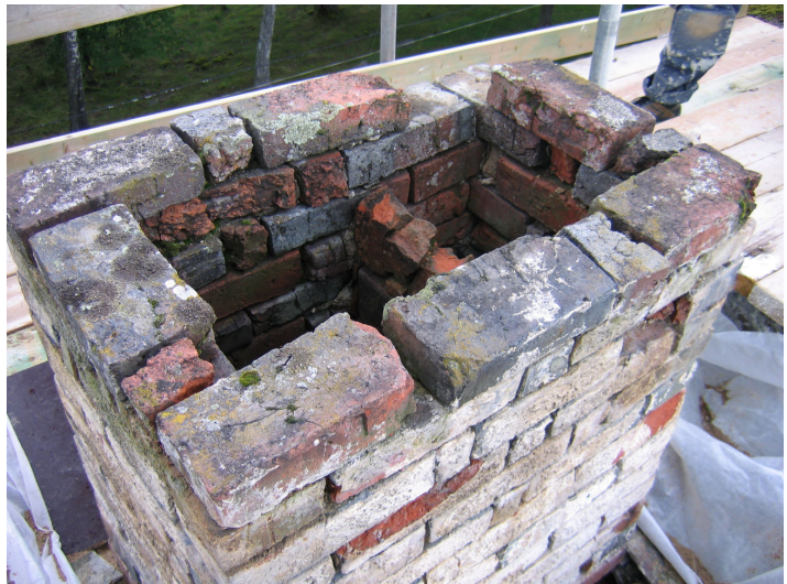
Skorstenarnas murverk före renoivering.
