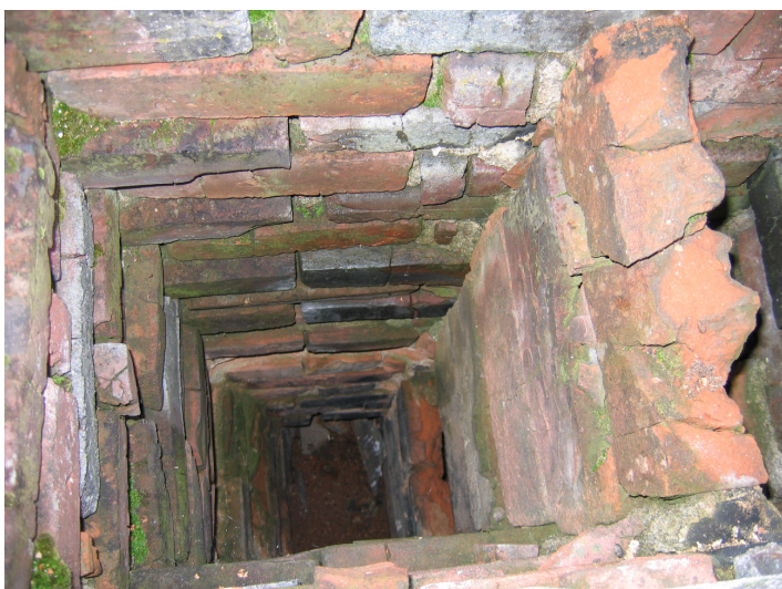
Skorstenarnas murverk före renoivering.
